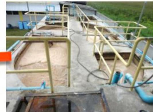
ถังเติมอากาศ
