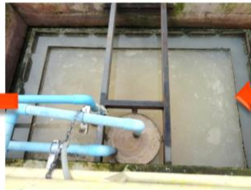
บ่อดกตะกอน
