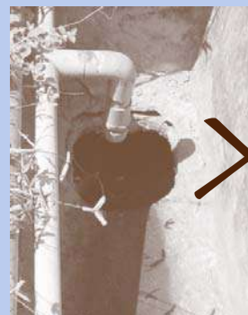
ภาพที่ 6 : ทางระบายน้ำนอกอาคารไม่มีตะแกรง ดักเศษอาหารเพื่อป้องกันการอุดตัน
