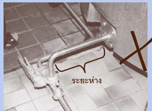
ภาพที่ 49 : การติดตั้งวาล์วห่างจากถัง
