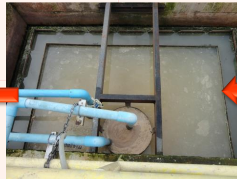
5 บ่อดกตะกอน
