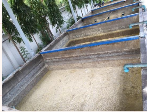
2 บ่อดักไขมัน 2 และบ่อสูบน้ำเสีย 2
