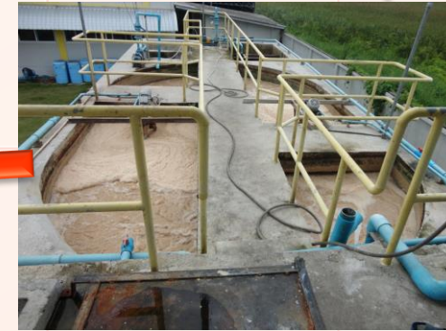
4 ถังเติมอากาศ
