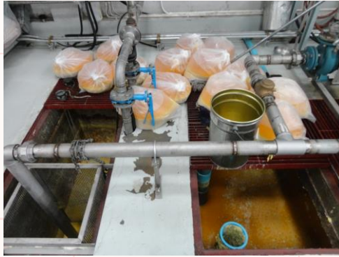
1 บ่อดักไขมัน 1 และบ่อสูบน้ำเสีย 1
