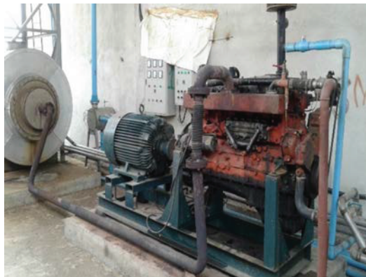
ภาพที่ 33 นำก๊าซชีวภาพที่ได้มาทดแทนการใช้ไฟฟ้าโดยใช้เครื่องปั่นไฟฟ้า
