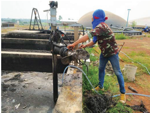
ภาพที่ 34 - 35 บ่อรวมน้ำเสียและบ่อสูบตะกอน
