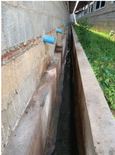
ภาพที่ 7 รางระบายน้ำที่ดี ไม่มีมูลสุกรและน้ำเสียตกค้าง
