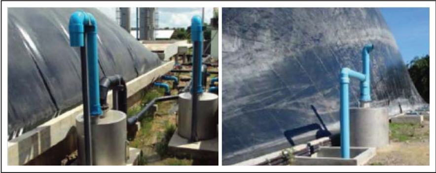
ภาพที่ 40 ชุดควบคุมแรงดันก๊าซชีวภาพ
