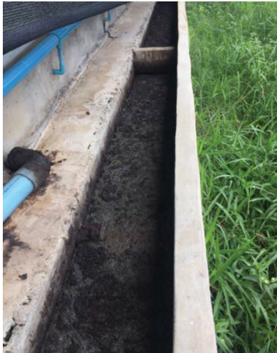
ภาพที่ 6 รางระบายน้ำเสียที่การระบายน้ำไม่ดี ทำให้มีมูลสุกรคั่งในท่อ ก่อให้เกิดกลิ่นเหม็นและเป็นแหล่งเพาะพันธุ์สัตว์พาหะ
